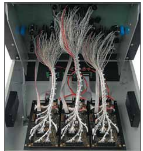
Рис. 1. Пример незакрепленного внутреннего электро монтажа с продольной вязкой пластиковыми поясками
