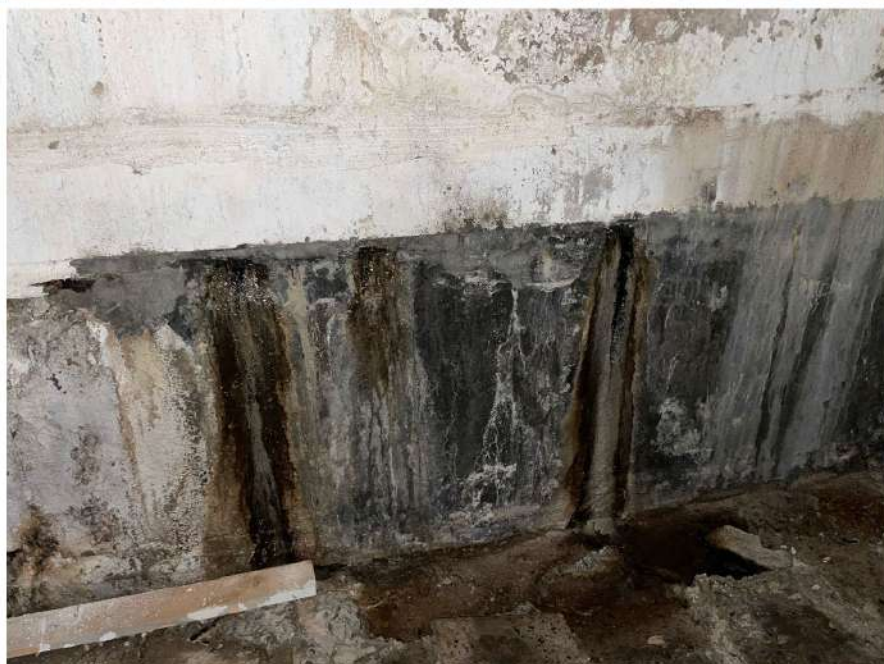
Рис. 11,12 Ремонт аварийного подвала на объекте Городская клиническая больница имени С.С. Юдина по адресу г. Москва, Коломенский проезд, 4, состояние до ремонта
