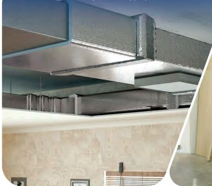
СИСТЕМЫ ВЕНТИЛЯЦИИ И КОНДИЦИОНИРОВАНИЯ
