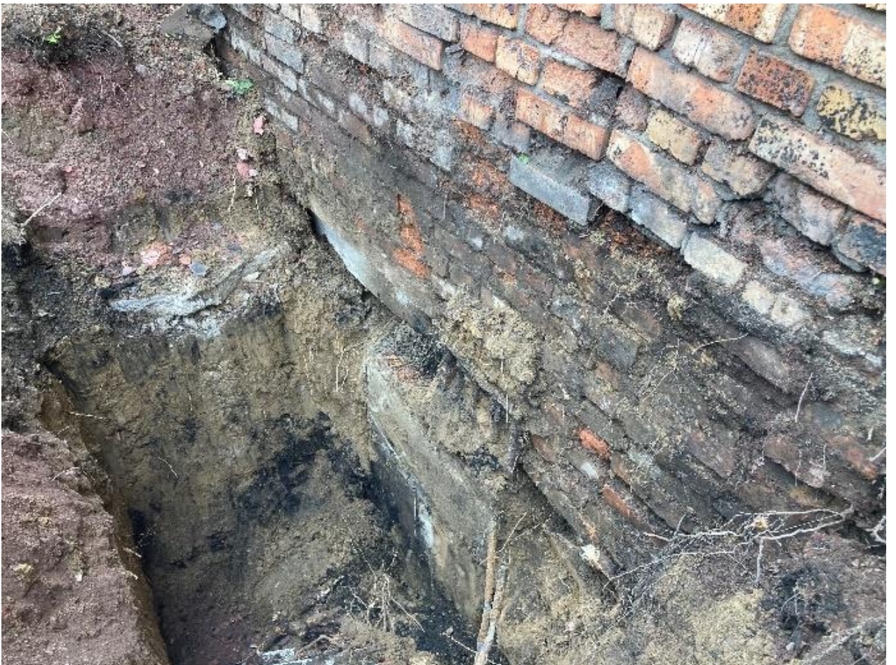
Отсутствие вертикальной гидроизоляции фундамента
