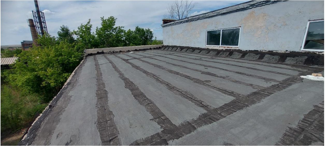
Разрушение гидроизоляционного ковра
