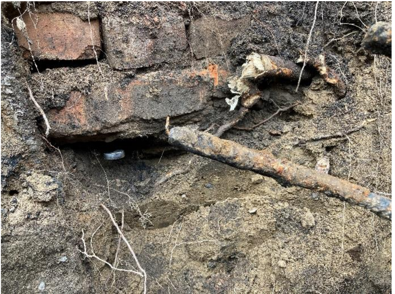
Отсутствие фундаментов под отдельным участками кирпичных стен
